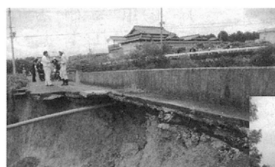
松池 堤防崩落状況 (5月25日AM)
